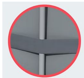
Foto 2: NOK , cinta de compressão na parte externa dos postes de sustentação da piscina
